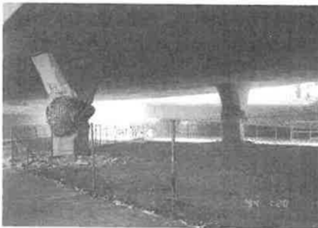
写真 5.5.28 LP3-1 橋脚の被害 (曲げせん断破壊) 2)
