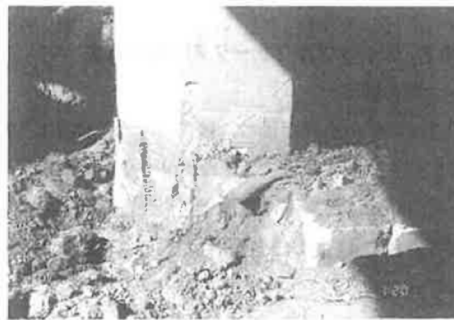
写真 5.5.31 RP2-2 橋脚基礎の損傷 2)
