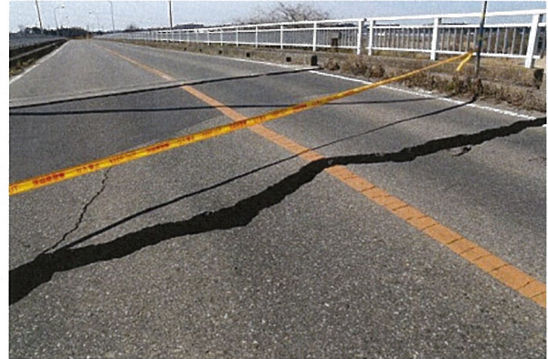
図 11 通行止めとなった橋梁（土浦市）
