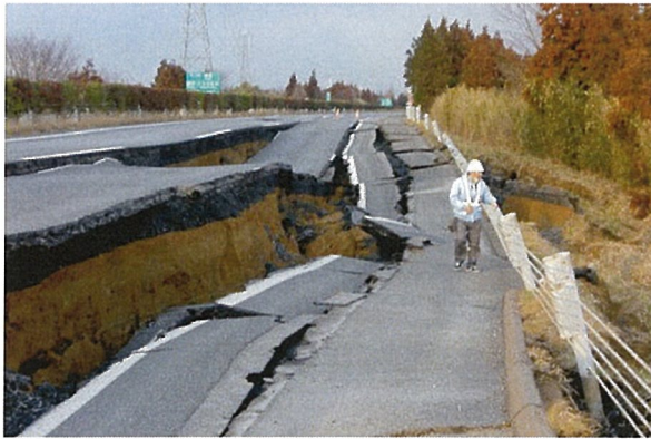
図 10 路面が陥没した常磐自動車道 (水戸～那珂)
