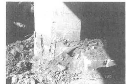
写真 5.5.31 RP2-2 橋脚基礎の損傷 2)
