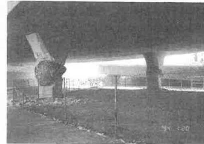
写真 5.5.28 LP3-1 橋脚の被害 (曲げせん断破壊) 2)
