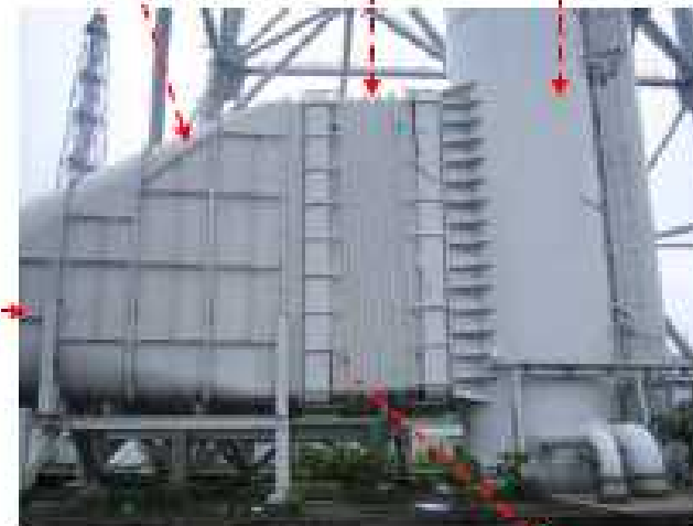
ダクト ペローズ 主排気筒
