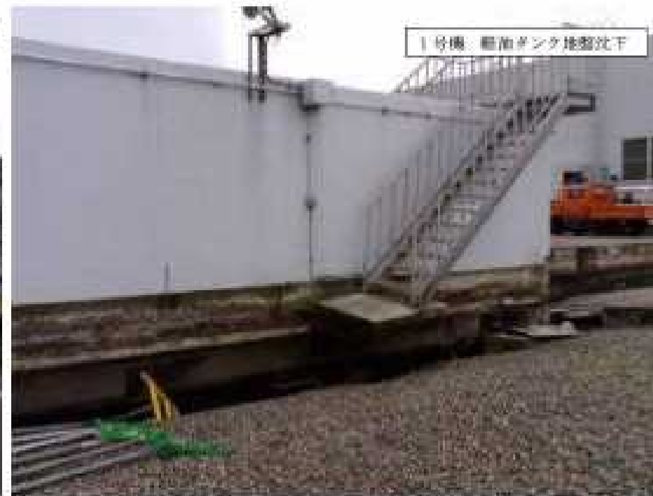
軽油タンク周辺地盤の沈下
