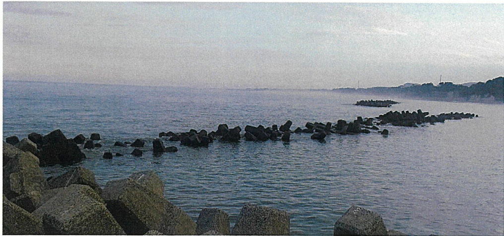
（会瀬海岸 整然と積み上げられた沖合テトラポットが崩れた様子）
