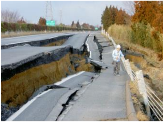
高速道路の崩壊(常磐自動車道那珂 IC 付近)
