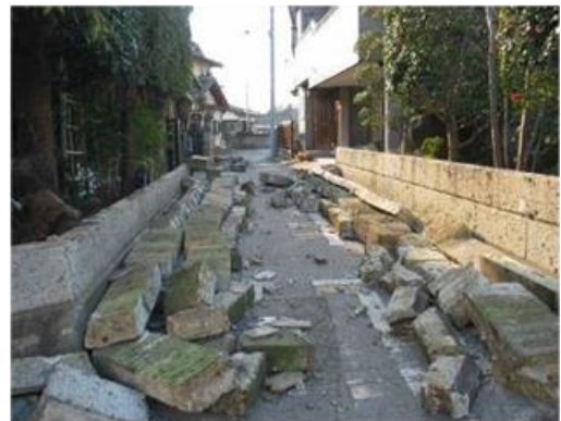
ブロック塀の倒壊(笠間市)
