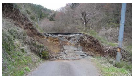
2011年4月11日の棚倉地震の変位(1.9m)と道路の切断(2013年原告団現地調査)
