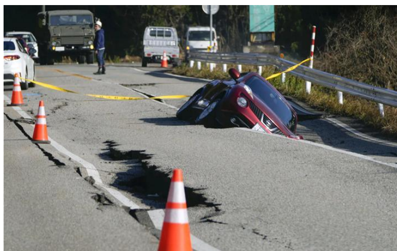
（甲G 3 1 9号証 4 6 頁・石川県穴水町）
