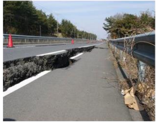
国道 51 号の亀裂・沈下(大洗町)
